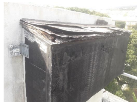
Figure 19: Gîte présentant une forte dégradation au niveau du toit avec décollement des strates de contreplaqué
